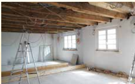
Der Aus- und Umbau von Teilen des GLG Kreiskrankenhauses Prenzlau erfolgt unter Berücksichtigung denkmalpflegerischer und ökologischer Aspekte.
